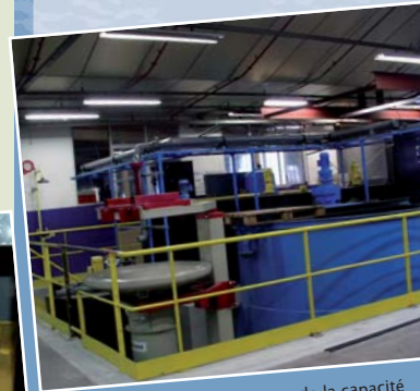
Modernisation et augmentation de la capacité de traitement de la station d'épuration des eaux industrielles.
