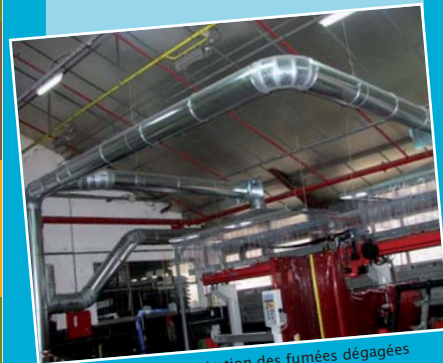
Aspiration des fumées dégagées par notre outil de production.
